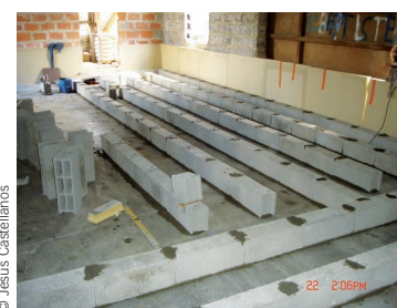
Sur le chantier d'un hypocauste, vue d'ensemble du labyrinthe où l'air chaud circulera.
