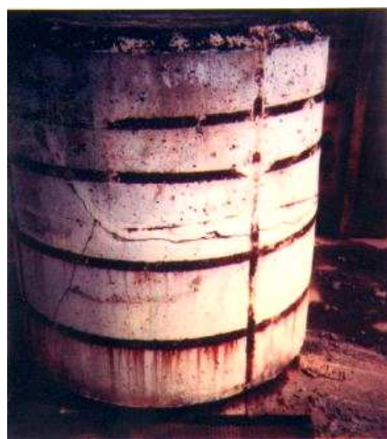
Coque bétonnée fissurée
