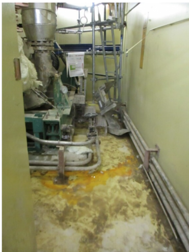
Dans un couloir de la zone contrôlée de la centrale de Tricastin, en janvier 2017.
