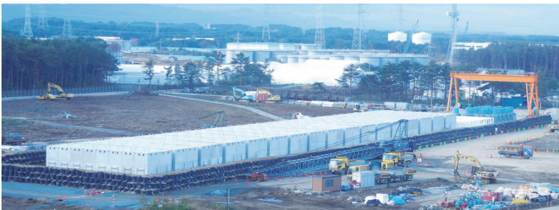
Stockage temporaire du césium extrait de l'eau contaminée (21 décembre 2011)
