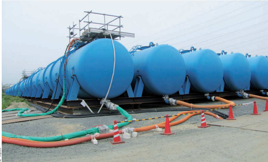
Citernes de stockage de l'eau contaminée (17 septembre 2011)
