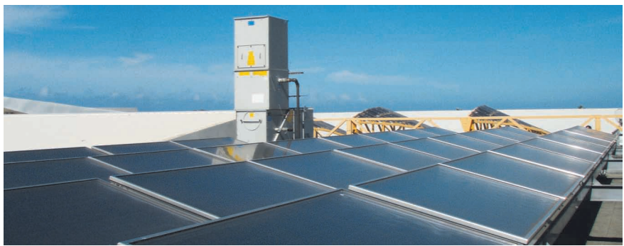
Vue du champ de capteurs et de la tour de refroidissement de l'installation de climatisation solaire qui rafraîchit les salles de cours de l'Université de la Réunion à Saint-Pierre, en fonctionnement depuis 2007.
